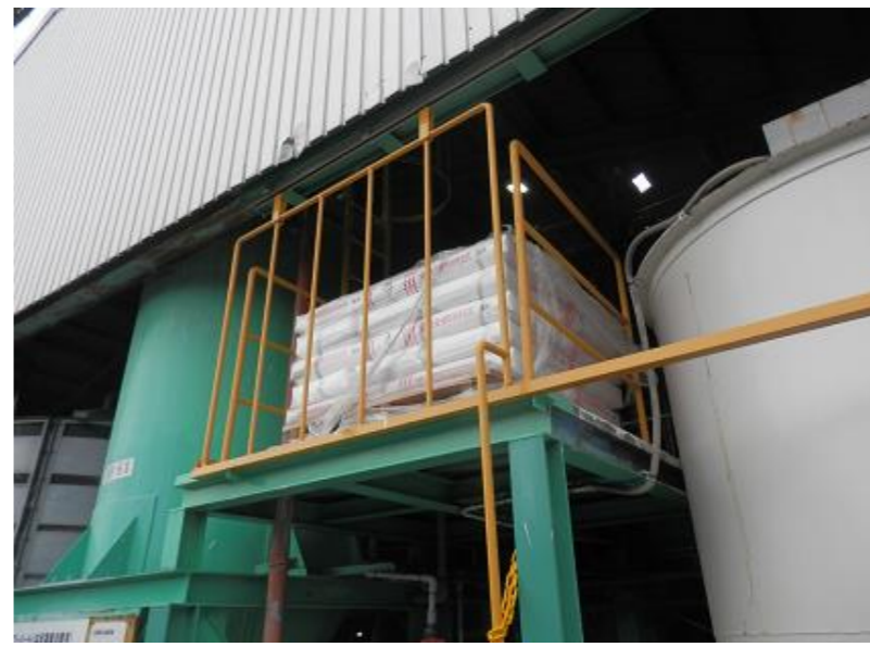
②廃水処理設備の高所箇所落下防止対策
