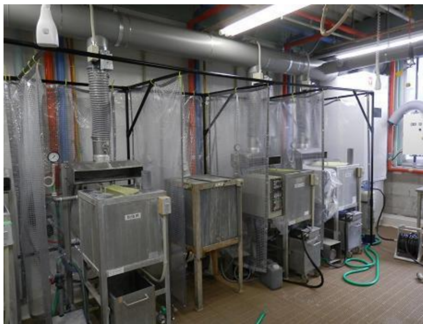
①実験棟 1F のスプレーブースの設備毎に局所排気を設置
