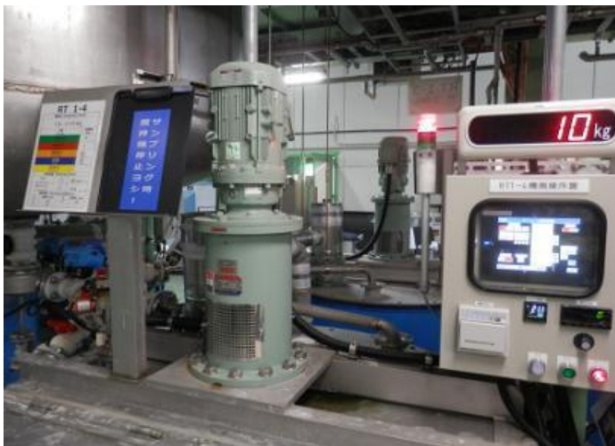
①操作盤による蒸気の一元取扱化
