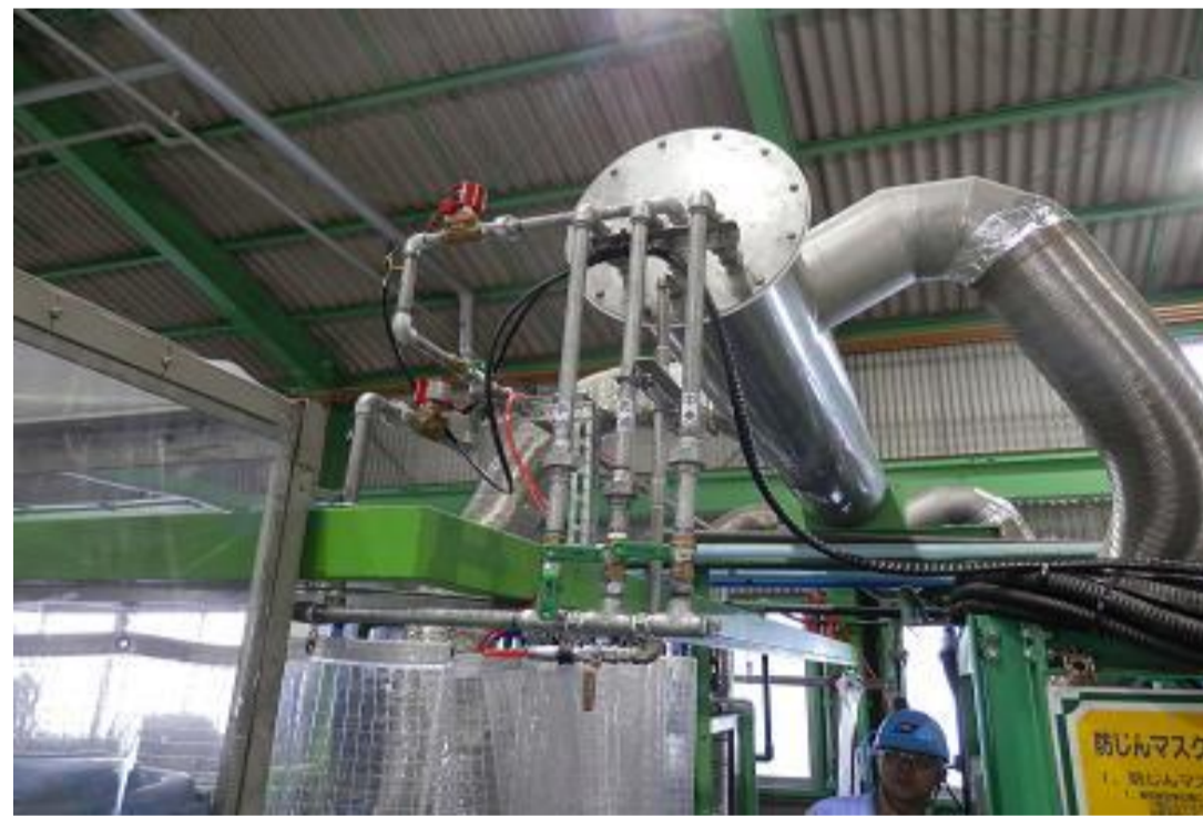
②集塵機ダクトの洗浄装置追加
